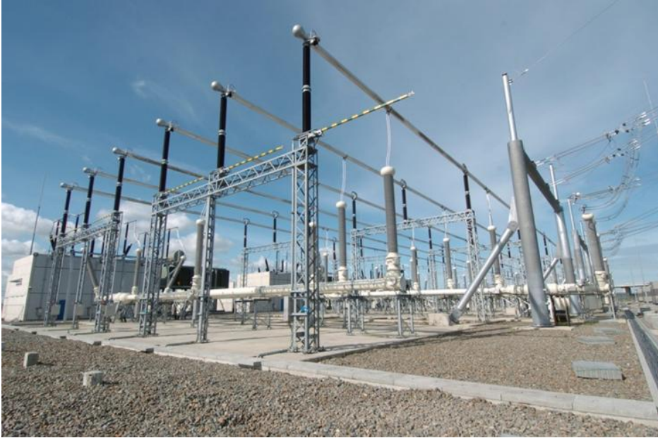
Foto 1 Foto van een veld met schakelapparatuur.
