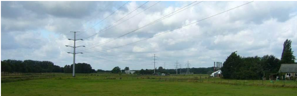
Foto 6 De huidige hoogspanningslijn loopt geknikt door het gebied. In combinatie met afwijkende masthoogtes ter plaatse van de Oude IJssel en de wisseling van masttype zorgt dit voor een rommelig beeld en een nadrukkelijke aanwezigheid van de lijn.
