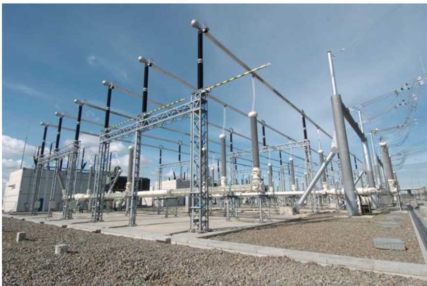
Foto 19: Impressie van een veld met schakelapparatuur
