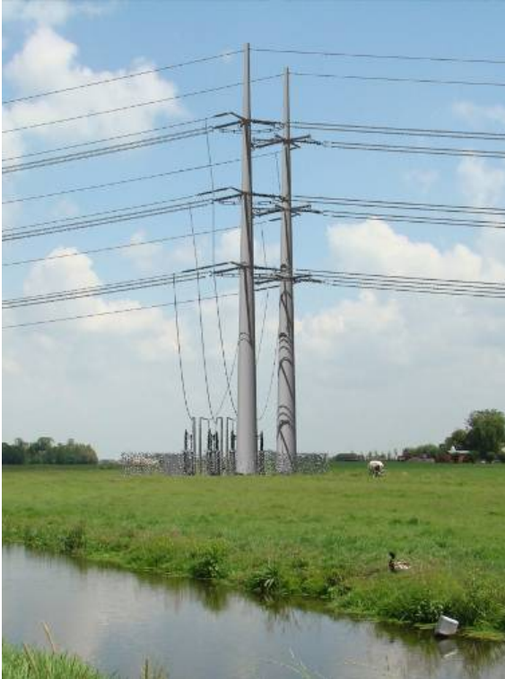
Foto 23: Impressie opstijgpunt 150 kV bij een Wintrackmast
