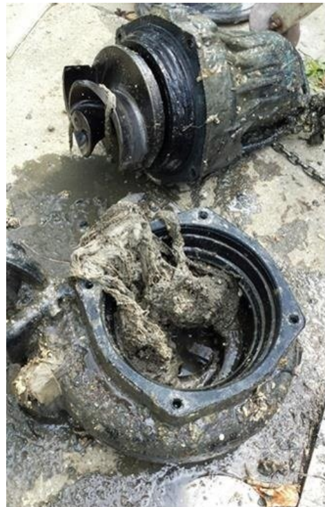
Doekjes in een rioolpomp
