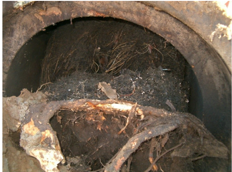
Ingroei van boomwortels in een betonnen riool
