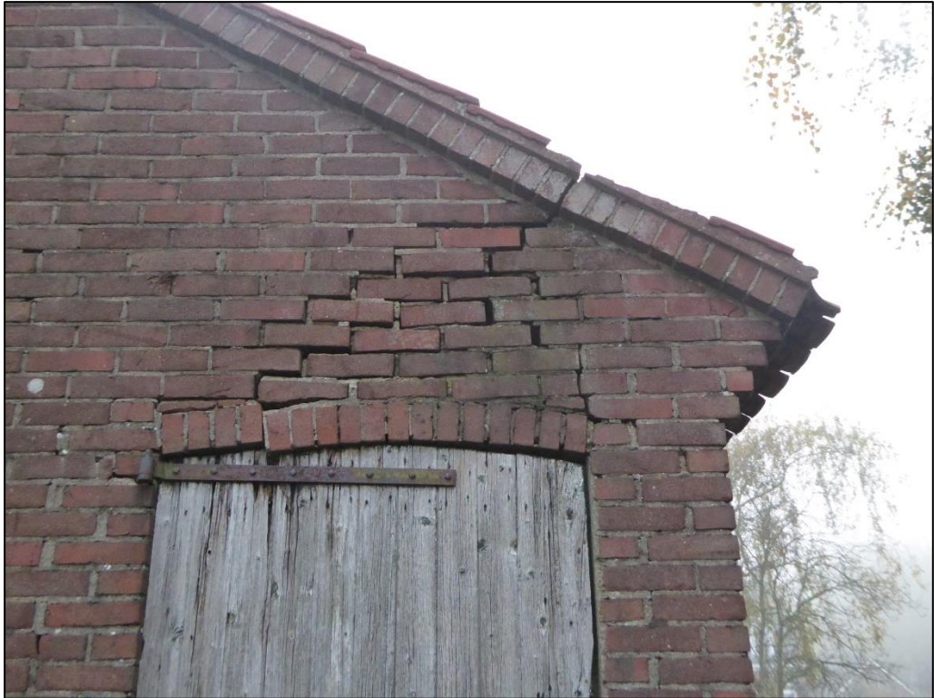
Scheuren in de muur, waar vleermuizen naar binnen kunnen kruipen en zo geschikte ruimtes kunnen bereiken.
