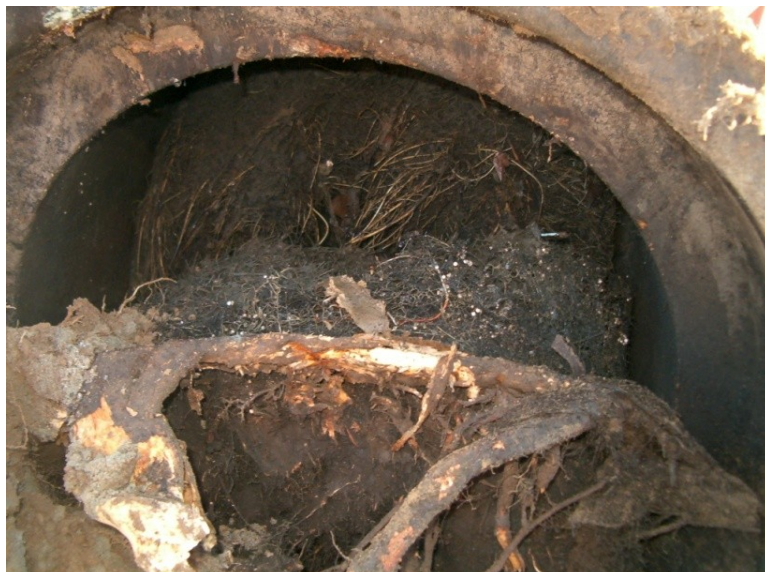
Figuur 6-11: Ingroei van boomwortels in een betonnen riool
