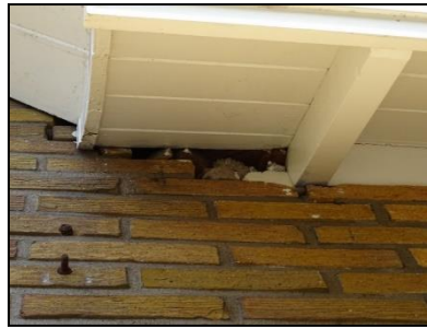
Figuur 16. Beschadigingen aan de muur, waardoor toegang tot de open spouw mogelijk is.
