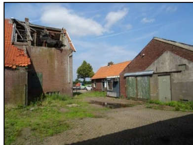
Figuur 4. De maalderij (links), het woonhuis (midden), het bijgebouw (midden) en de schuur (rechts).
