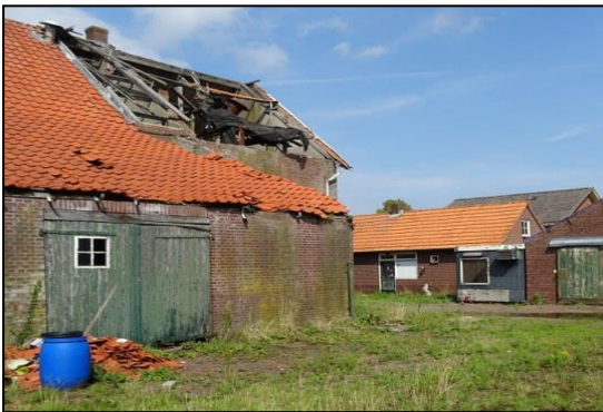
Figuur 14. Ingestort dak van de maalderij (foto van 2019, inmiddels is de maalderij nog verder in verval geraakt).
