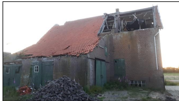
Figuur 15. Ingestort dak maalderij (foto van 2019, inmiddels is de maalderij nog verder in verval geraakt).
