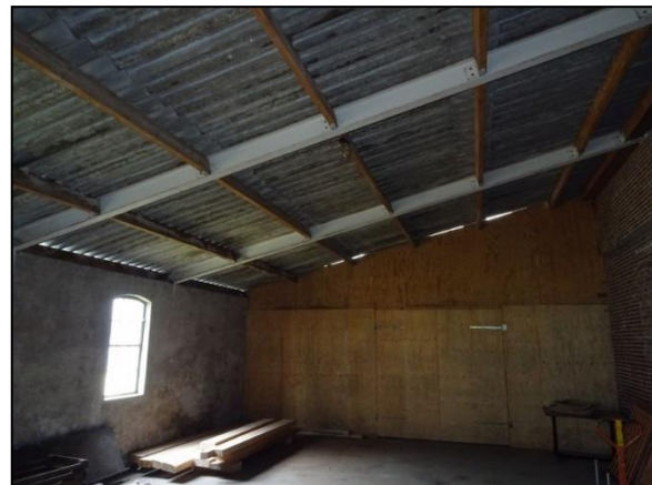
Figuur 11. Geen dakbeschot aanwezig daar waar de dak opening gerealiseerd wordt.
