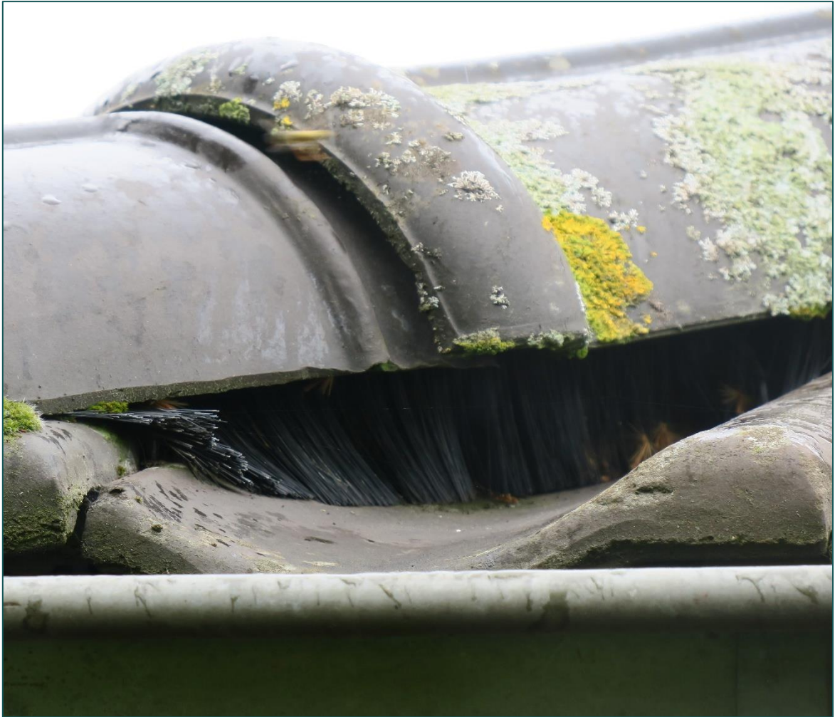
Figuur 3 De dakpannen van de schuur zijn gedicht met vogelschroot.
