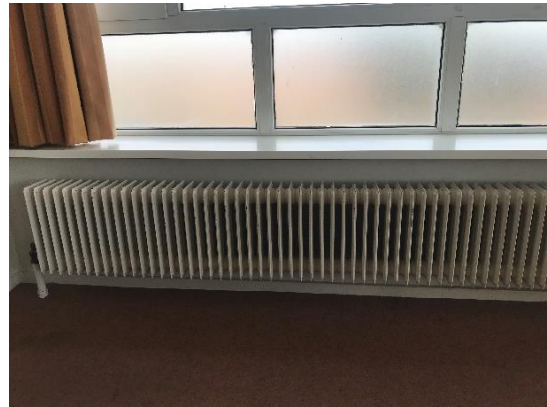
Installatie voldoet niet aan huidige normen
